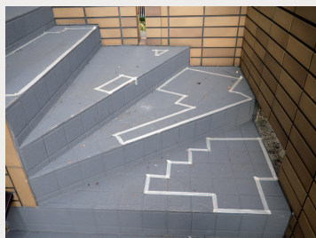
玄関ポーチタイルの浮き
