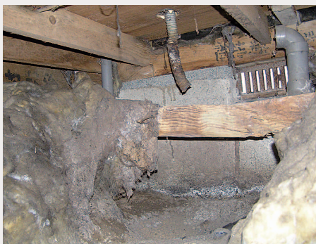
配水管の破損（床下）
