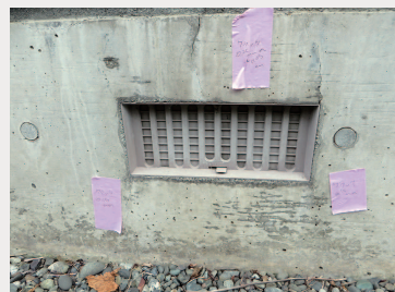
基礎クラック
